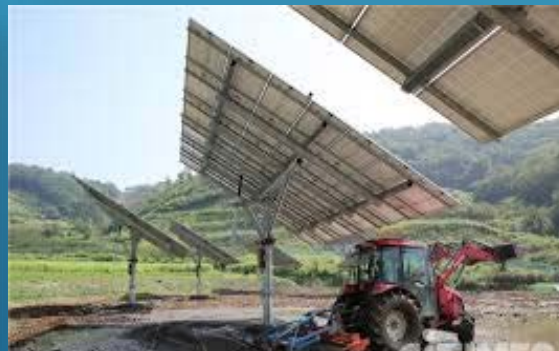
▲ 해남군 간척지 농업공존형 태양광. © 파루
